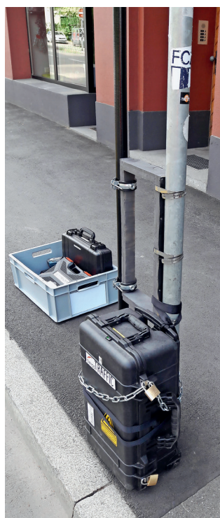
1 | Testinstallation der Kamera an der Höngerstrasse; Gesamtansicht (links) und Anordnung des Steuergeräts am Boden (rechts).
